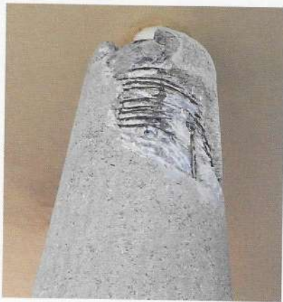
↑ Pilier avec aciers mis à nu.
